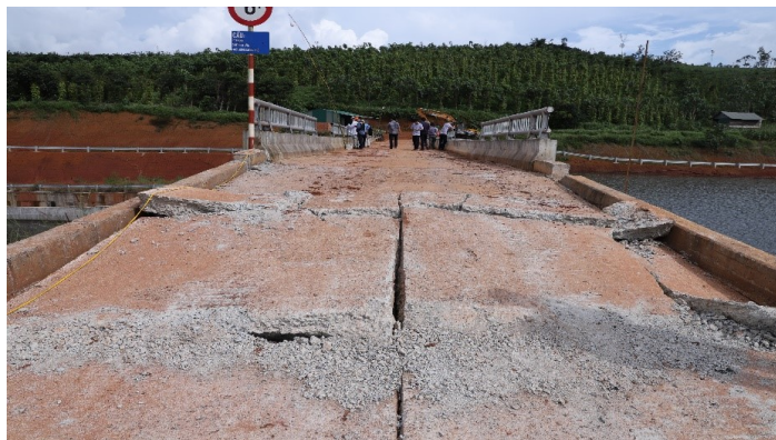
Xuất hiện nhiều vết nứt và điểm hư hại xung quanh khu vực hồ chứa nước Đăk N'ting
