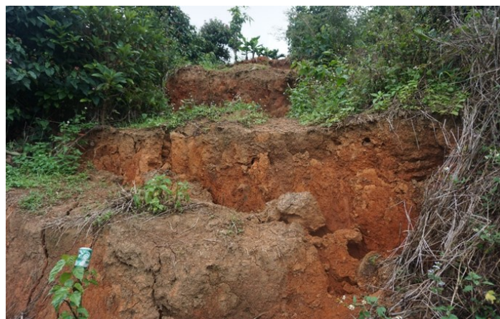
Dấu hiệu vết nứt, trượt lớn hình thành tại Hồ chứa nước Đồng Thanh
