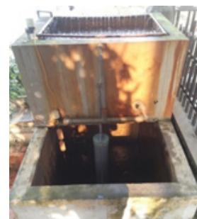
Thiết bị hấp phụ được lắp đặt loại bỏ As, amoni
