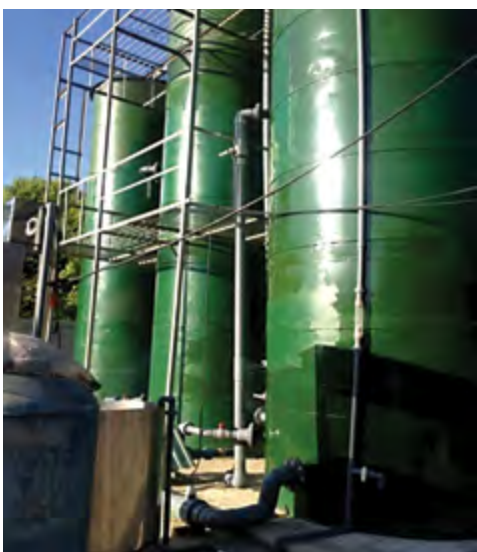
Hệ thống xử lý yếm khí
