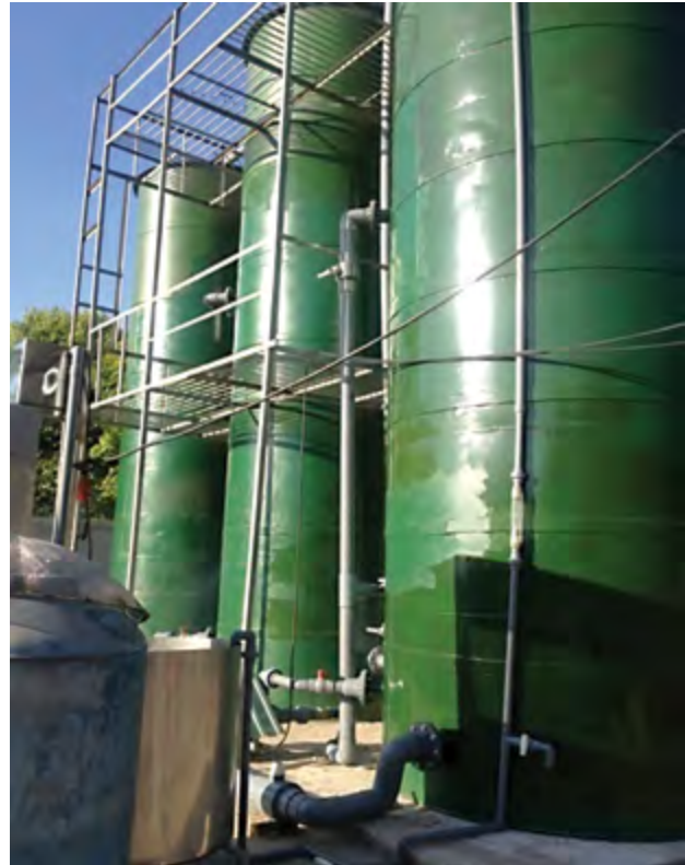
Hệ thống xử lý yếm khí tại Trại Hòa Bình Xanh
