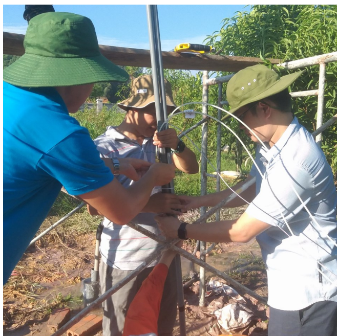
Nhóm nghiên cứu lắp đặt trạm quan trắc tự động độ lún nền, động thái và tính chất nước dưới đất tại thành phố
