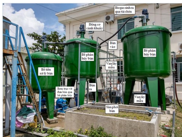
Hình 1. Mô hình pilot phân hủy bùn sinh khí phát điện được lắp đặt tại Trung tâm Công nghệ môi trường tại Đà Nẵng
